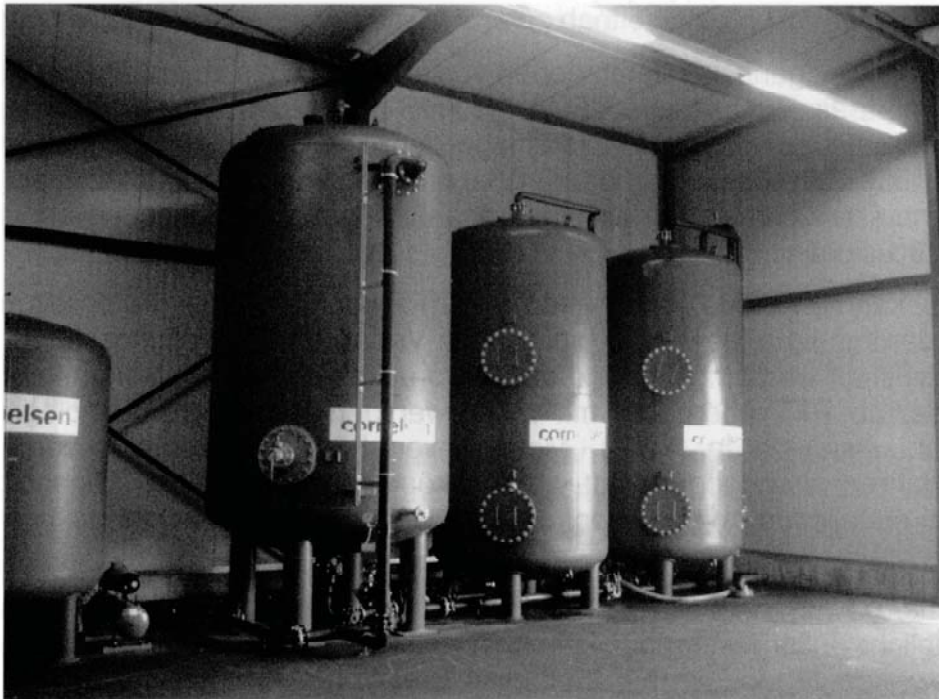
Abb. 2: Blick in die stationäre Aufbereitungsanlage in Brilon-Scharfenberg (Juli 2007)
